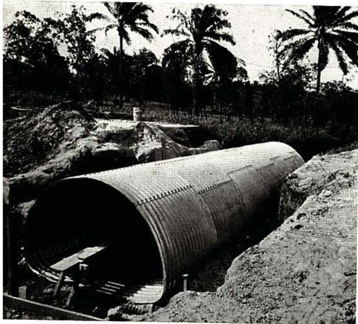
Dieser Rohrbogen hat 4,09 m Spannweite und 2,57 m Höhe. (Wegeverwaltung von Douala-Kamerun). (Photo G. Prunet-Douala).
