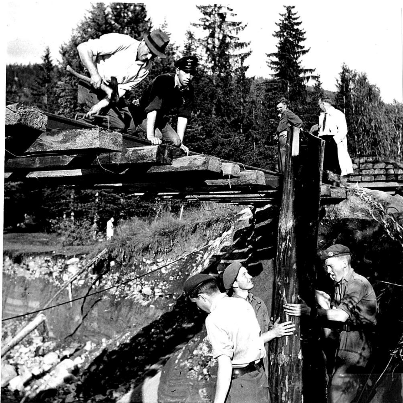
Ant. bak östre landkar bru over Vesleåa km. 153,1 Bergensbanen. Efter brudd 19-20/8-1951.
