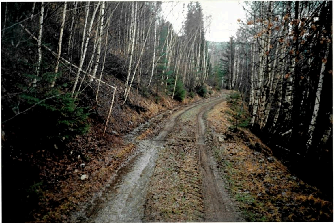
Behov for vegggrøft og stikkrenner
