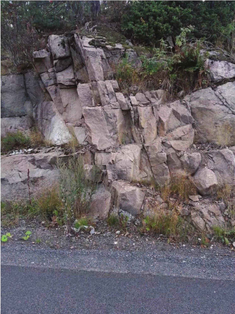
Figur 1 Fjellskjæringen er relativt oppsprukket, spesielt på høyre side av svakhetssone.
