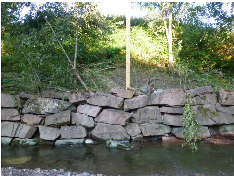
Foto nr.1. Foten av skråningen rett etter flommen (foto: Håvard Strøm).
