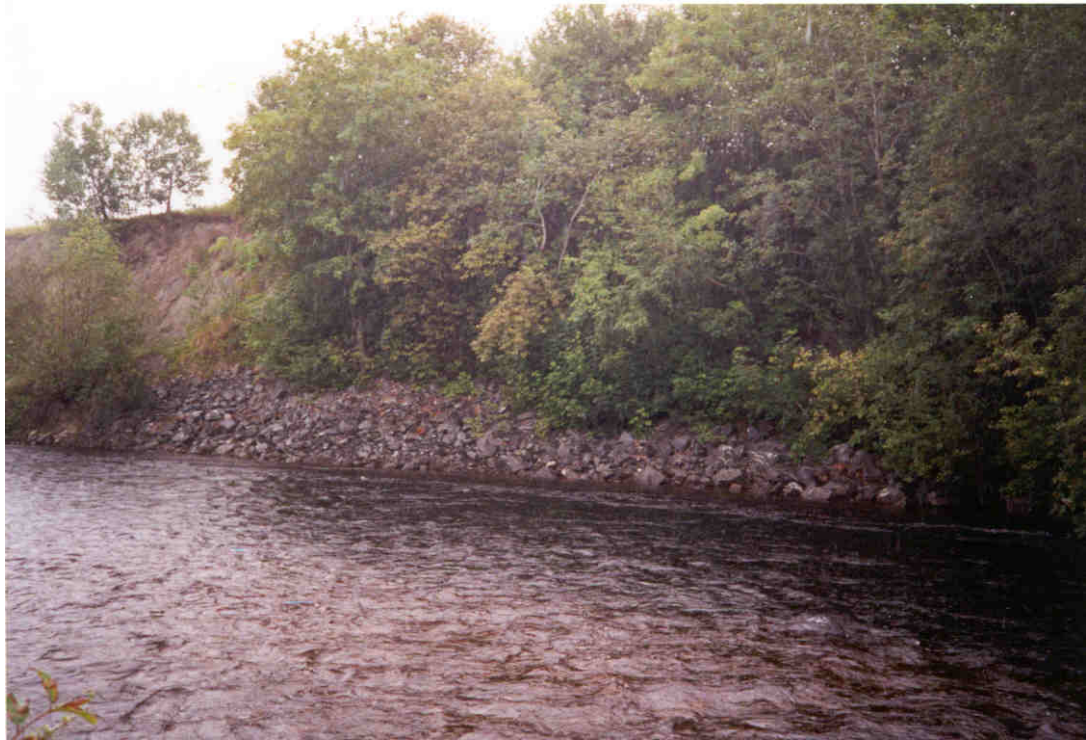
Figur 6-1 Skråning ved profil B som bør plastres ytterligere (Bilde fra NVE).
