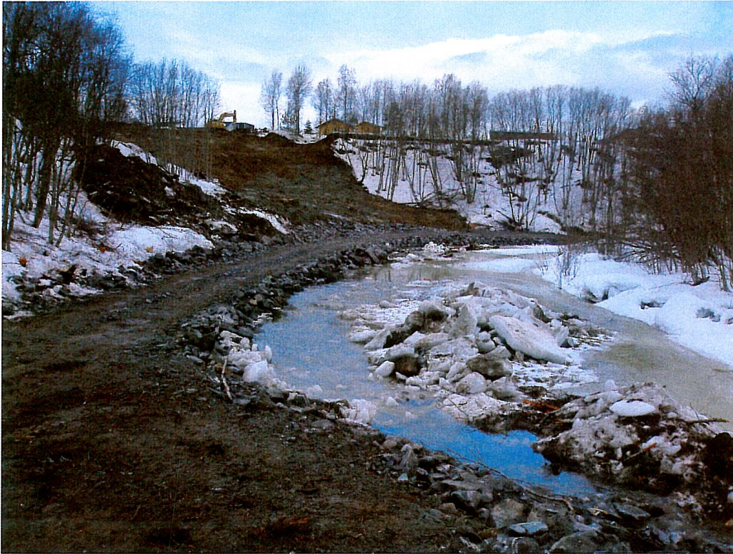
Fra nedstrøms ende av forbygning og forbi rasgrop
