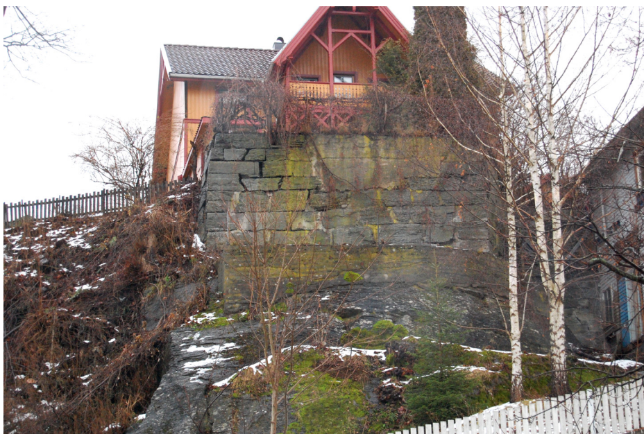
Figur 4.4 Eksempel på støttemur med sprekker
