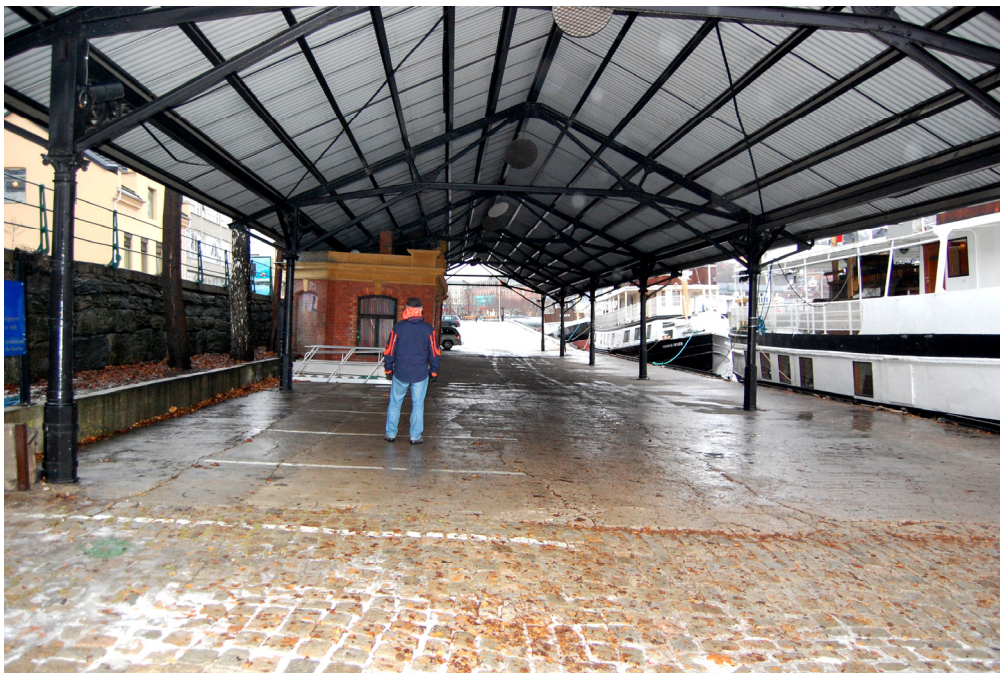
Figur 4.6 Området som har fått betydelige deformasjoner
