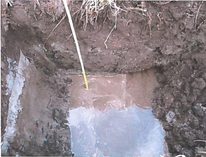
Bilde 4. Gravehull 2, vann inn fra drensledning.
