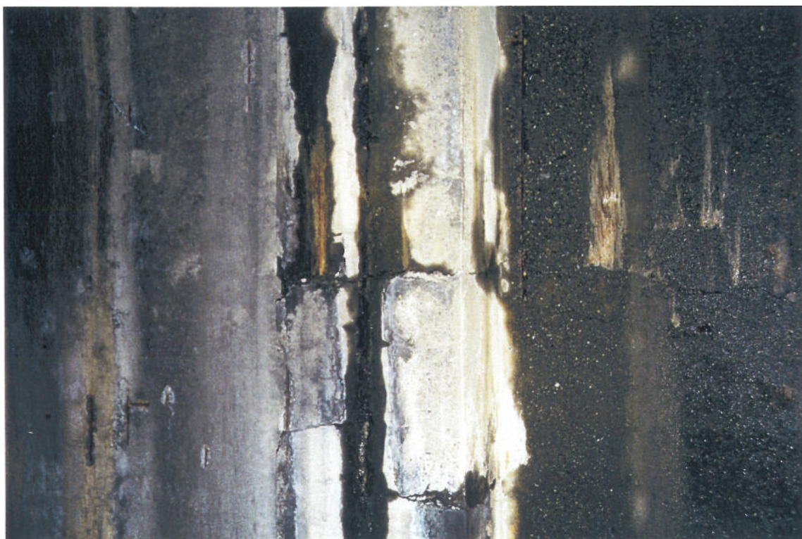
Bilde 4.3.2. Sprekker i betongsøyle.
