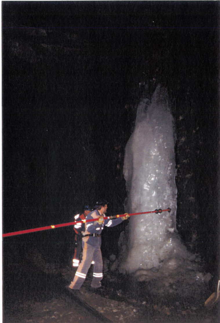
Bilde 4.9.3. Isdannelse ved pel 600 i Grønbogen vendetunnel.
