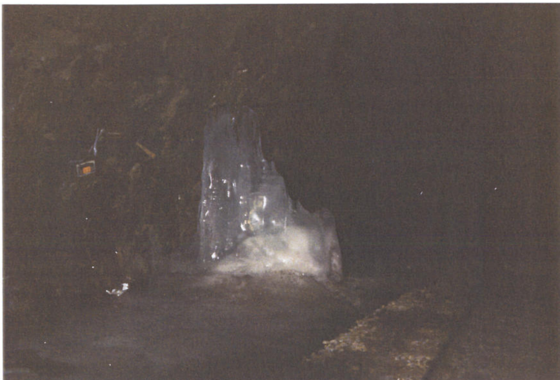
Bilde 4.9.2. Isdannelse i Grønbogen vendetunnel.
