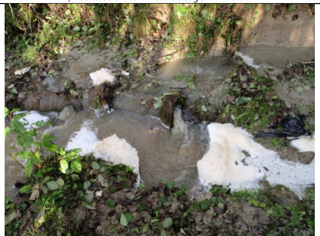
Bilde H 6 Ødelagte rør i ravine nord for Hørsdalen
