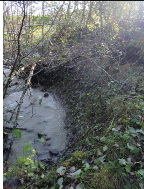
Bilde H 8 Erosjon i yttersving (sone Rødde) etter bekk kommer ut av rør
