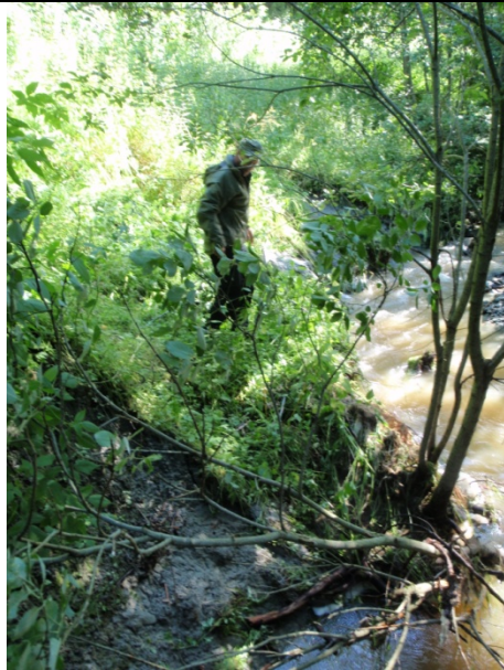
Bilde L 1 Erosjon i yttersvinger, sørside
