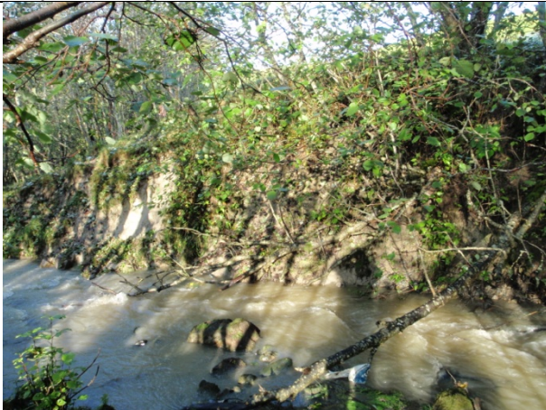
Bilde H 9 Erosjon i yttersving (sone Litj-Ler) etter bekk kommer ut av rør
