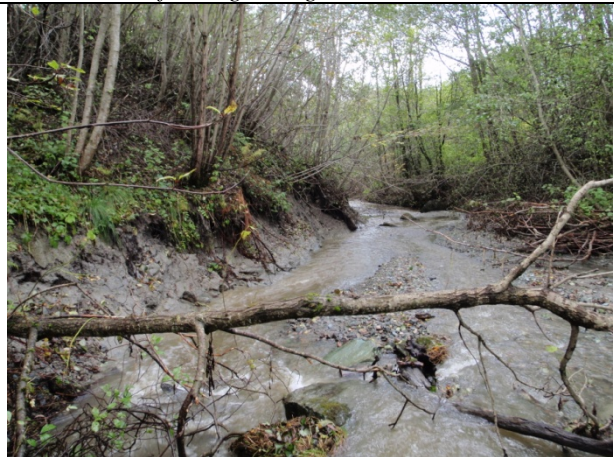
Bilde L 4 Utrasning sørside, like nedstrøms vegkulvert
