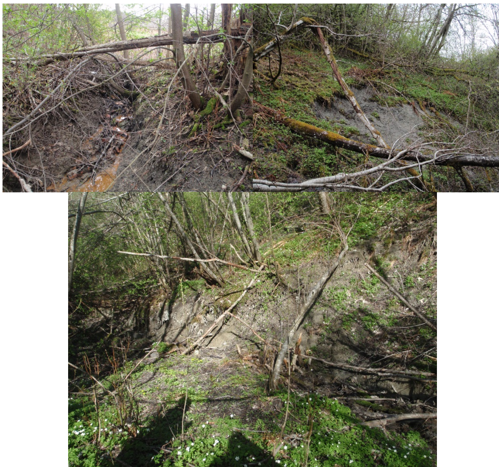
Figur 9: Bilde nr. 255 (venstre), 258 (høyre) og 35 (nederst) viser noe erosjon i Leirabekken.
